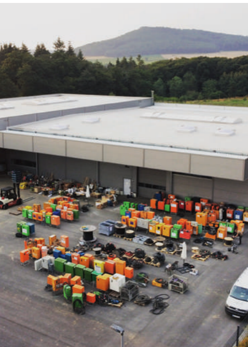
Gespendete Stromaggregate und Baustromverteiler (Bild: Elektrotechnik Tietz)
